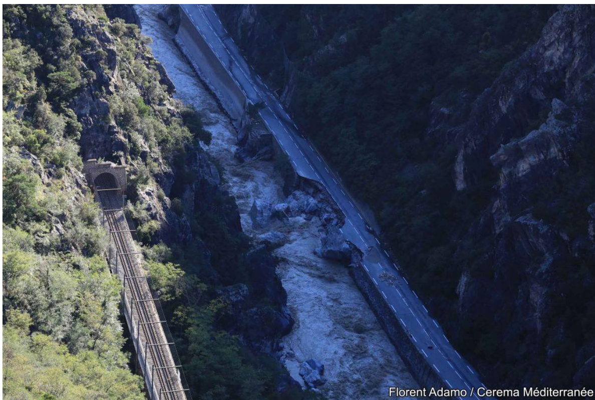
▲ Photo 60 : Roya au niveau des gorges de Berghe. Coupure de route en rive droite Vue amont -> aval Cliché : F. ADAMO, CEREMA. Localisation : cf. Figure 100, réf. P1
