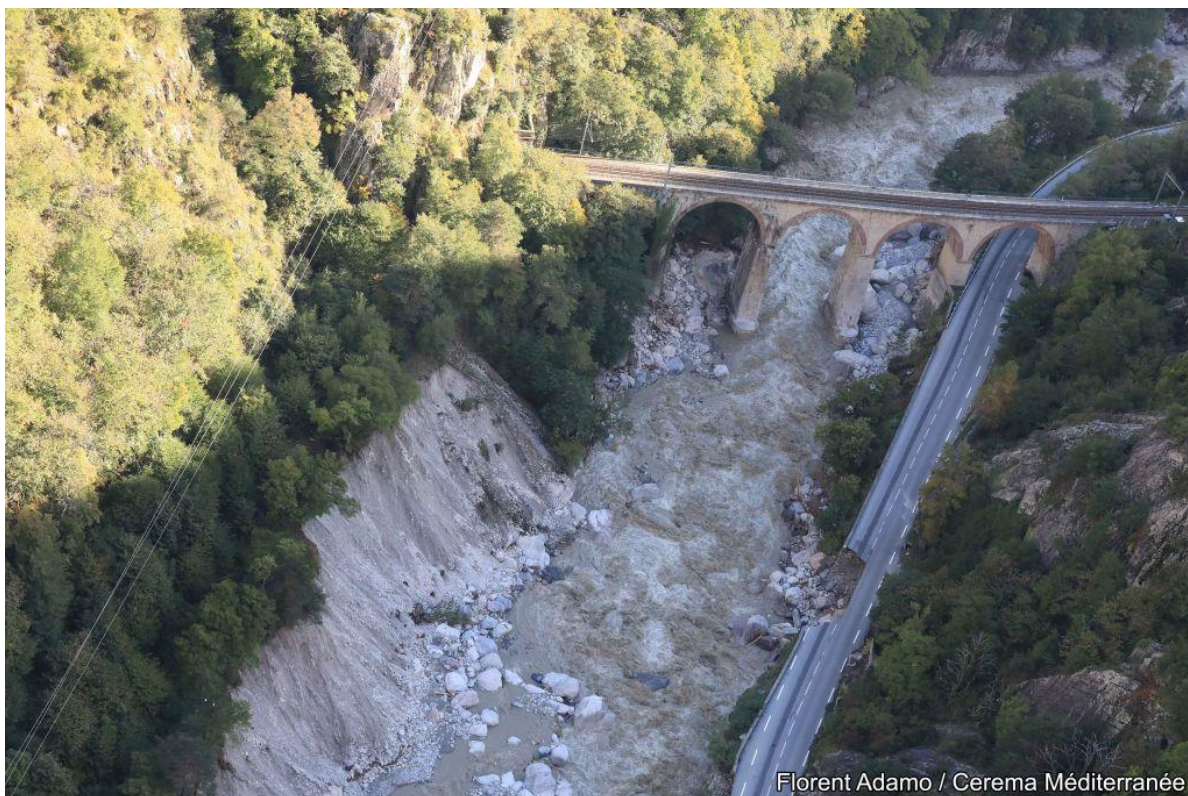
▲ Photo 51 : Lit de la Roya en amont du viaduc de la voie ferrée (aval confluence avec Bieugne). Brèche dans la route. Vue amont -> aval. Cliché : F. ADAMO, CEREMA. Localisation : cf. Figure 94 réf. P8
