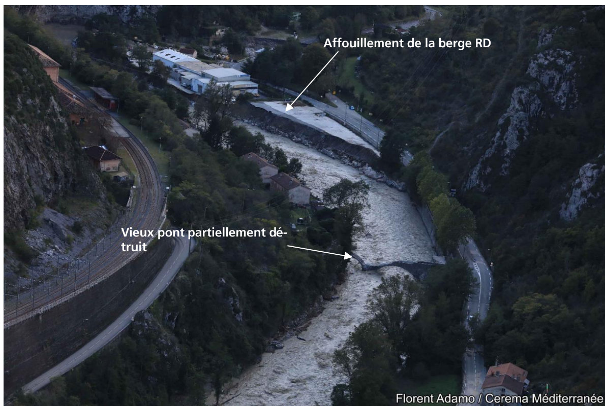
▲ Photo 64 : Roya entre le Bourg de Fontan et la confluence avec le Caisos. Vue amont -> aval Cliché : F. ADAMO, CEREMA. cf. Figure 100, ref. P5
