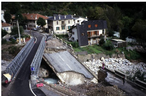
▲ Photo 6 : Crue du 13/09/1993. Destruction du pont de la Bieugne en amont de la confluence avec la Roya. Cliché pris après reconstruction d'un pont métallique. Source : RTM
