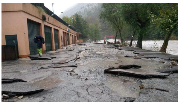
▲ Photo 10 : Crue du 05/11/2014. Breil-sur-Roya. Inondation des services techniques. Source : RTM
