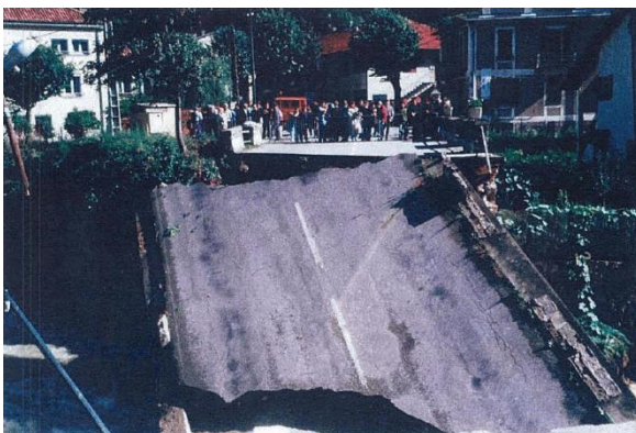
▲ Photo 5 : Crue du 13/09/1993. Destruction du pont de la Bieugne en amont de la confluence avec la Roya. Source : BRGM, 2005
