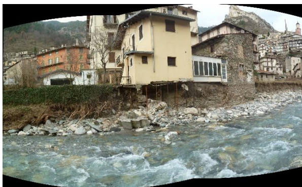
▲ Photo 12 : Affouillement de fondation de bâtiment à Tende. Cliché 19/12/2016. Source : RTM
