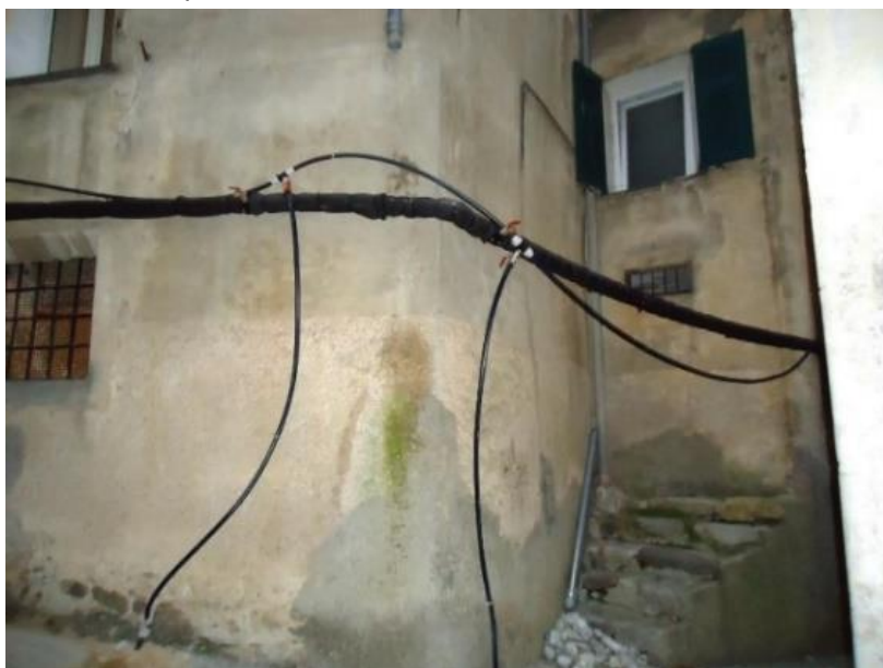
Figure 60. Vue du réseau public d'eau potable dans la ruelle Cachiardi, le 23 février 2013. (cliché P. Balandier)
