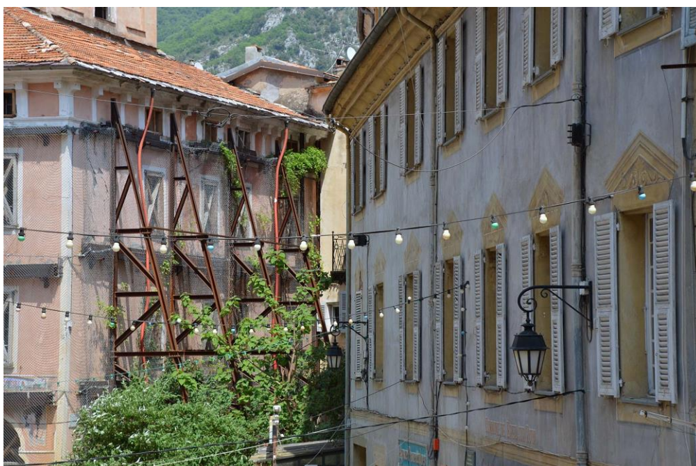
Vue du soutènement d'un immeuble très affecté par un tassement de sol, plusieurs années après son évacuation.
