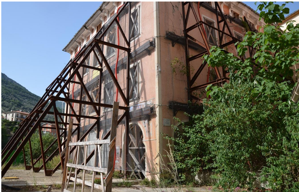
Figure 70. Etat de la maison Guidi et de la ruelle Cachiardi en juin 2022. L'impact sur les canalisations des racines d'un arbre, qui a atteint le 3 ème étage des immeubles pendant l'été, mériterait une attention plus soutenue.
