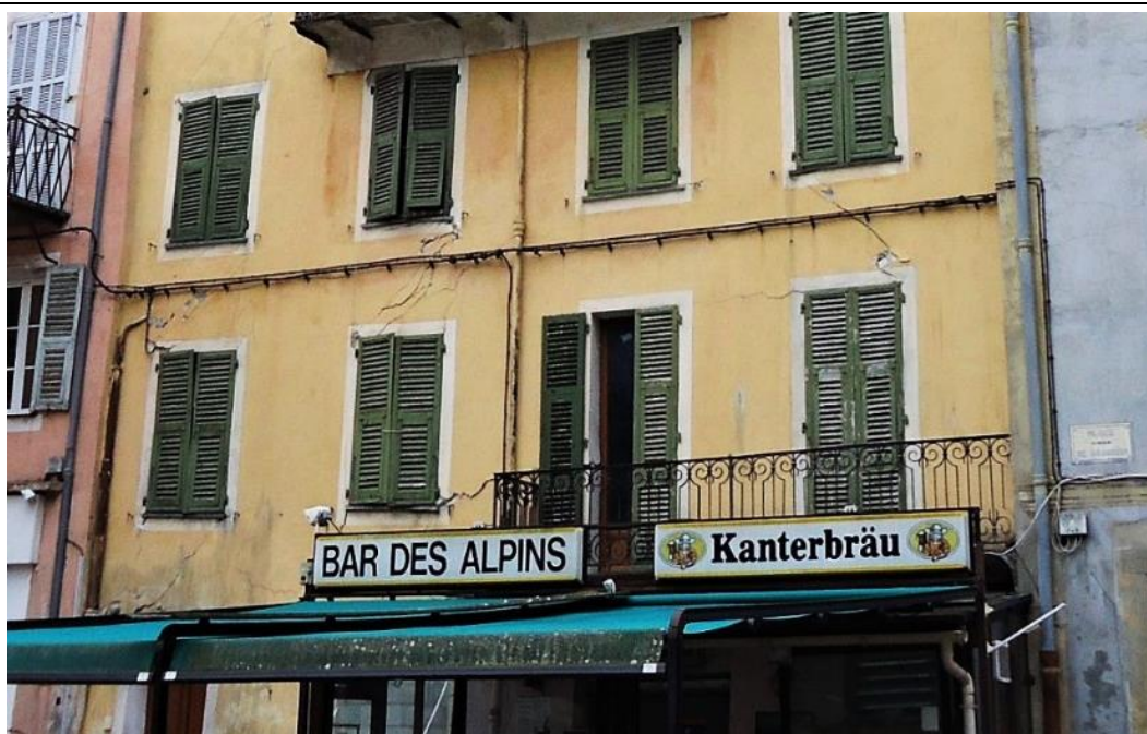
Figure 58. Immeuble Gambaraza le 23 février 2013. Le mur de refend central s'est affaissé et toutes les allèges gravement lézardées témoignent des désordres intérieurs. (cliché P. Balandier)
