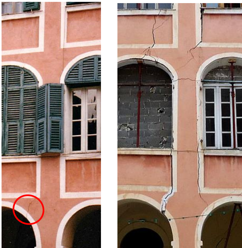
Figure 49. A gauche, en 1994 un début de fissure était visible à droite de l'arcade centrale de la maison Guidi. (Cliché P. Balandier)
