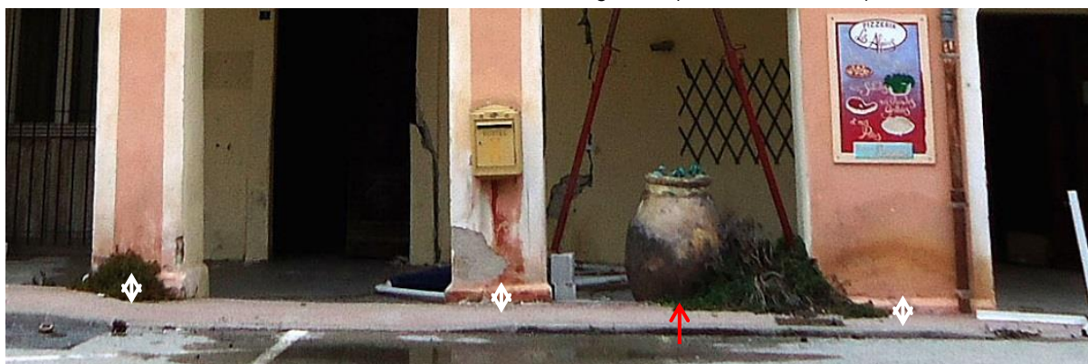
Figure 35. Vue en février 2013. La place a été à nouveau remontée de 15-20 cm (à une date non identifiée). La base des piliers des arcades a été recouverte. Le sol de la place se trouve désormais plus haut que le sol sous les arcades, y favorisant l'écoulement et la stagnation des eaux de pluie. (Cliché P. Balandier)
