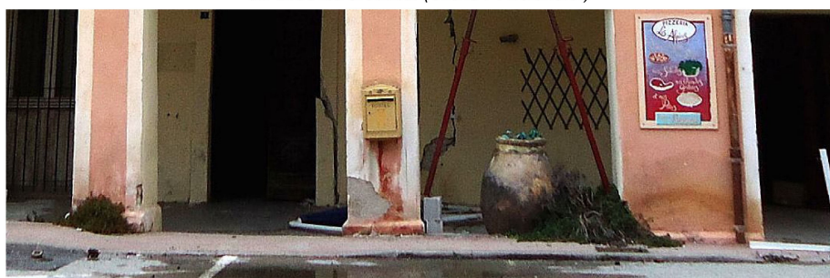
Vue en février 2013. La place est à nouveau remontée de 15-20 cm. Le trottoir créé le long de la façade et les places de parking se trouvent désormais plus haut que le sol sous les arcades, où les eaux de pluie doivent désormais s'échapper par les fissures dans la dalle. (Cliché P. Balandier)
