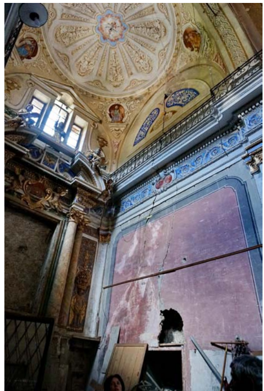
Fissure sur le mur nord-ouest Vue vers le Nord
