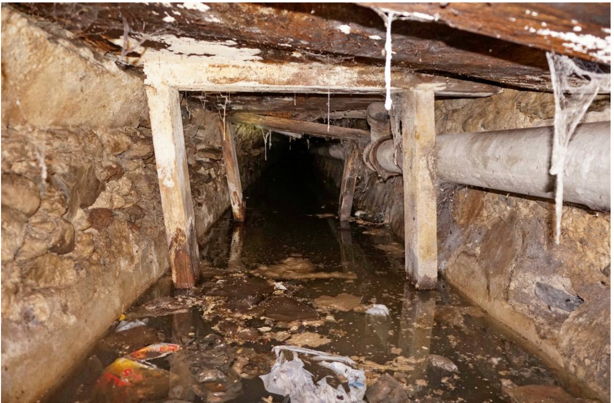
Etais en bois pour reprise bétonné de la voûte (suite à effondrement de la voûte ?) La galerie est inondée par les eaux usées et les eaux pluviales. Vues vers le Sud-Ouest.
