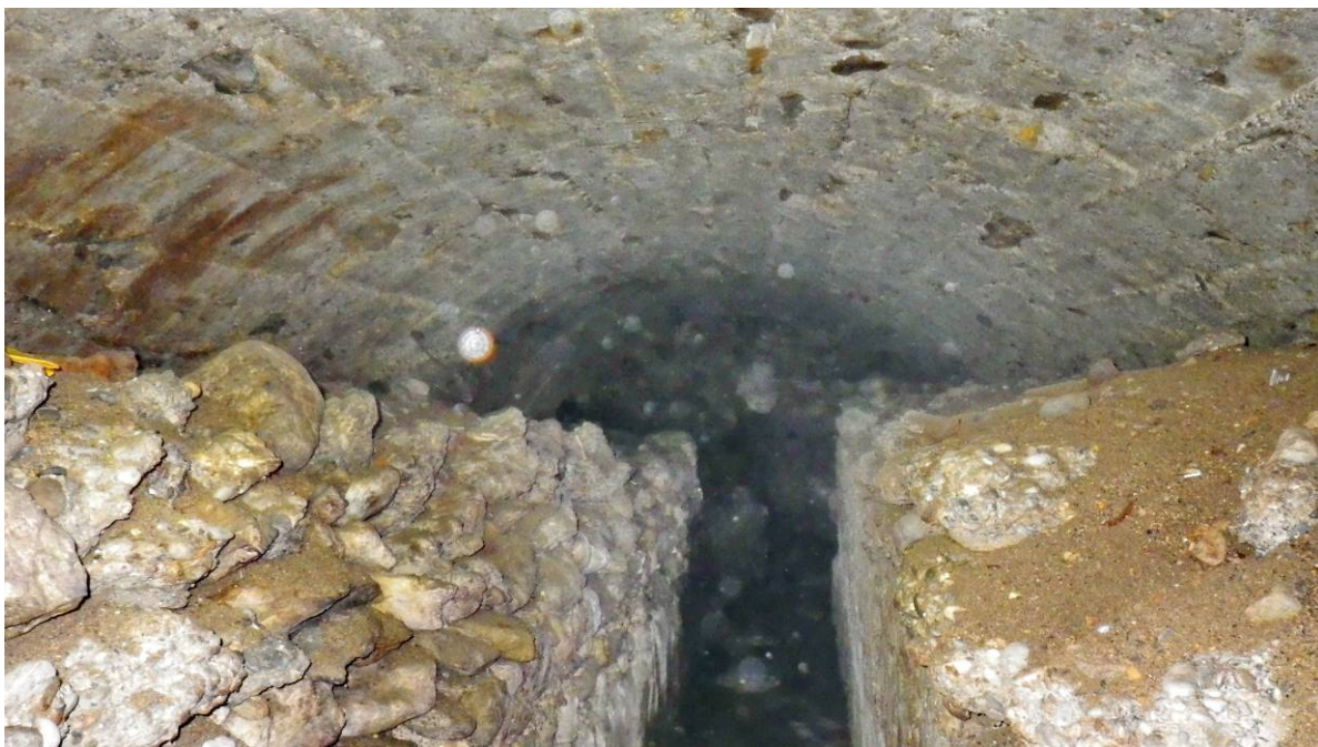
Sous une voûte commune datant de fin XIX ème, le canal Boéri et Toesca se rapprochent. Le canal Toesca (à l'Est) a été remblayé. Vue vers le Sud (vers l'aval)
