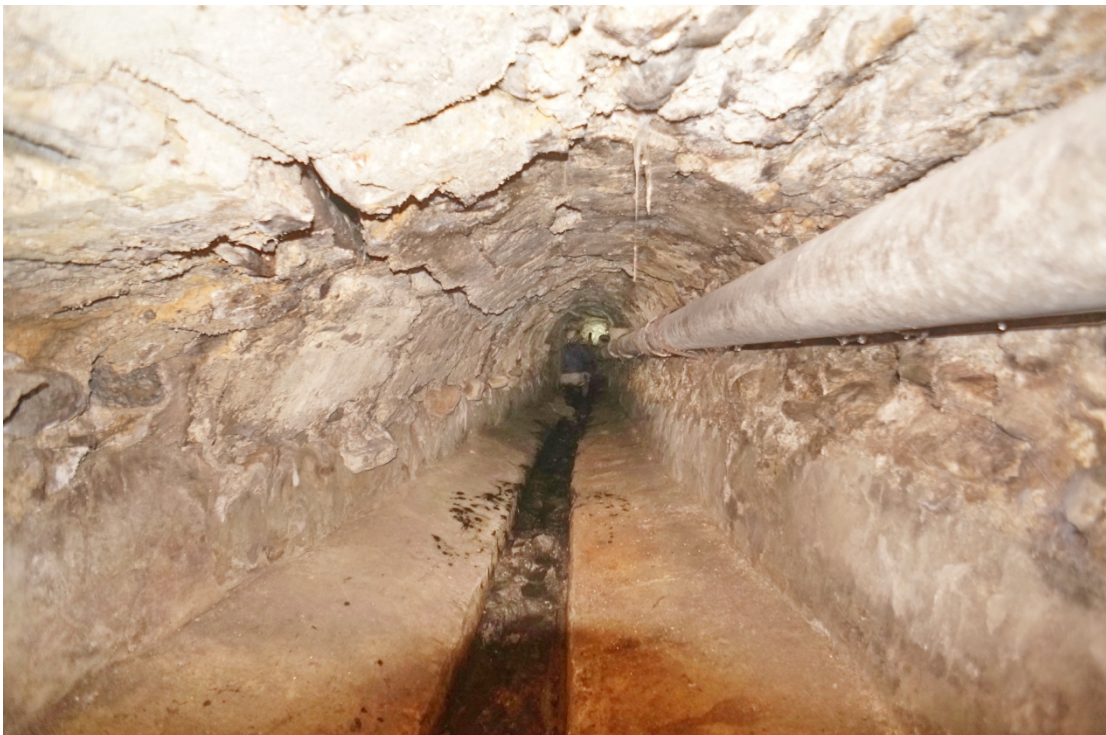
Vue du canal vers le Sud-Ouest, immédiatement après la ruelle Montfleury. Noter la fissure longitudinale à la naissance de la voûte côté Est, qui se poursuit. L = 1,2 \text{ m} , H = 1,15 \text{ m}
