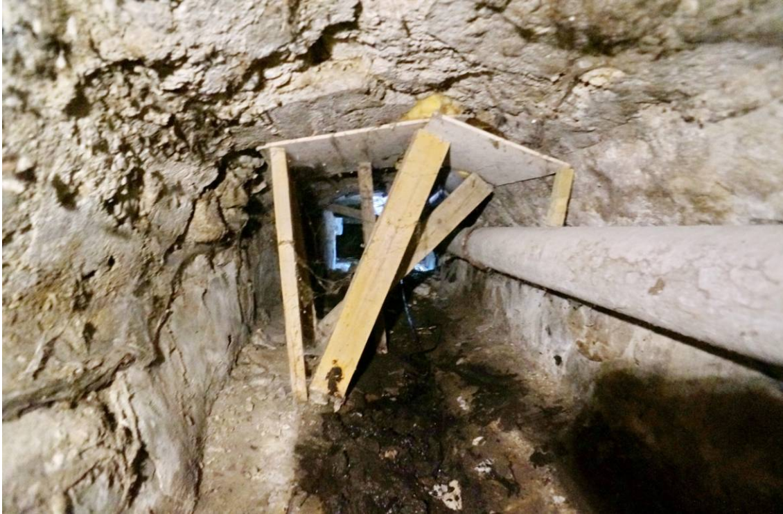
Partie étayée sous l'angle Nord-Ouest du bâtiment Guidi. Radier fissuré. Vue vers le Sud-Ouest.
