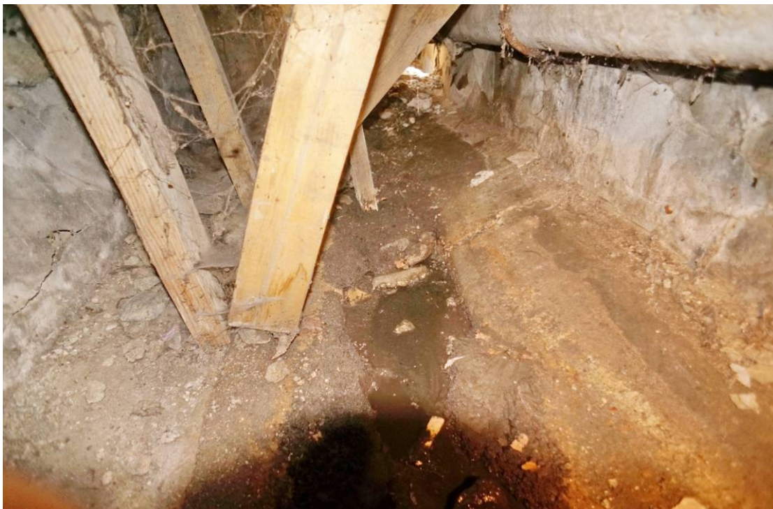
Infiltration des eaux-usées/eaux pluviales dans les fissures du radier. Vue vers le Sud-Ouest.
