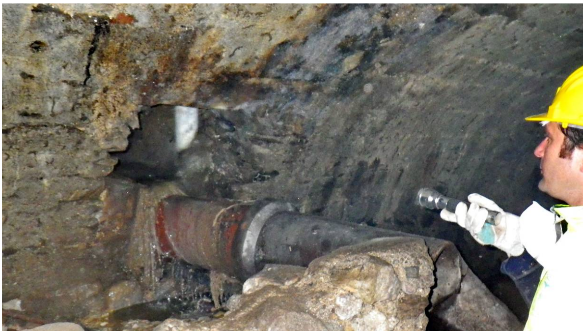
Cette galerie récupère une partie des EU de la rue Pasteur et des eaux pluviales de gouttières Vue ver l'Est
