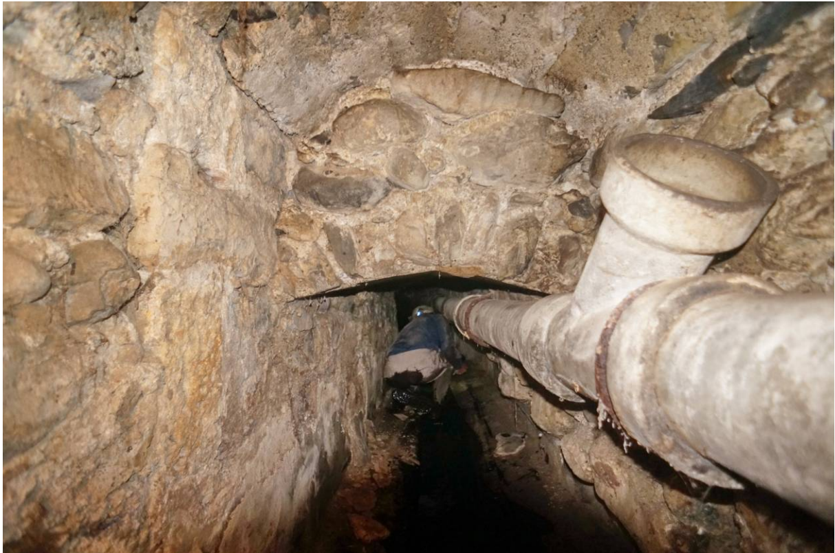
Tronçon de canal sous le Bar de l'Etoile, en resserrement. Reprise maçonnée de la voûte. L = 0,5 H = 1,0 m. Vue vers le Sud-Ouest.
