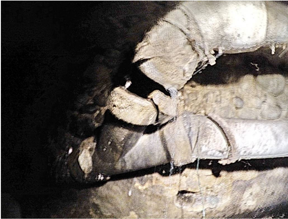
Canalisation EU rompue et perte des effluents dans le canal. Vue vers l'Ouest.
