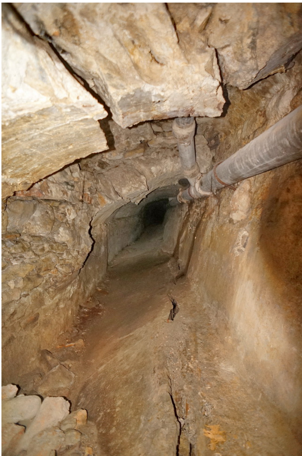
Voûte déformée et déversée vers l'Est, partiellement effondrée par endroits. Radier affaissé vers l'Est et fissuré. Nombreuses réparations partielles. L = 1,4 m H = 1,5 à 1,6 m. Vue vers le Sud-Ouest.
