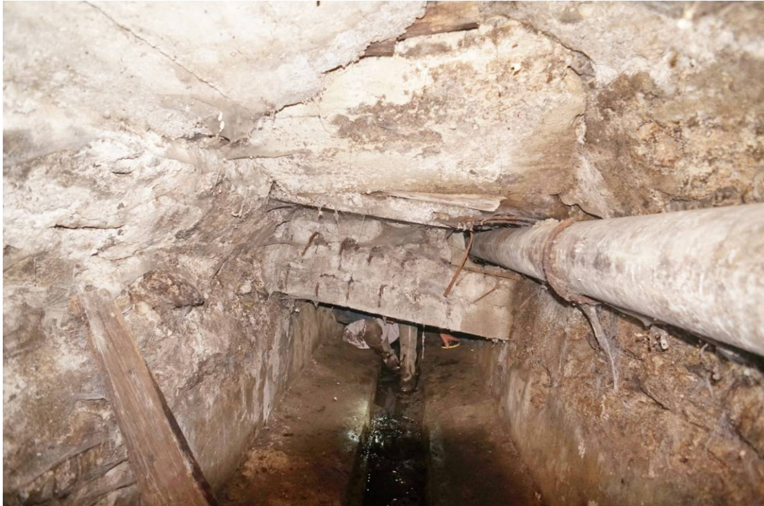
Passage d'un petit canal EP passant sous la ruelle Montfleury. Débordement possible dans le canal. Nombreuses réparations partielles de la voûte à différentes époques. Vue vers le Sud-Ouest.
