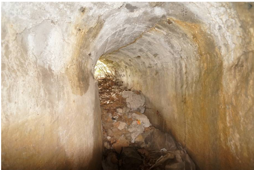
La cote d'entrée du radier est à 284,00 m NGF environ Vue vers le Nord-Ouest.
