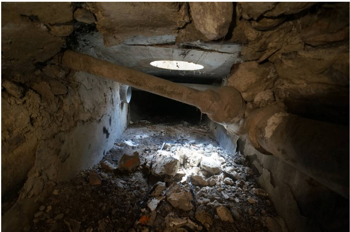
Regard/grille EP sous la place Brancion, canalisation PVC d'eau pluviale en provenance du Sud-Est de la place Brancion. Parois et voûte en mauvais état. Vue vers le Sud-Ouest.
