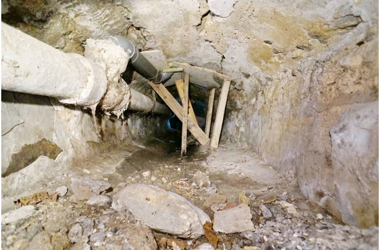
Vue vers le Nord-Est sur la partie étayée. Noter la reprise de la voûte elle-même fissurée.
